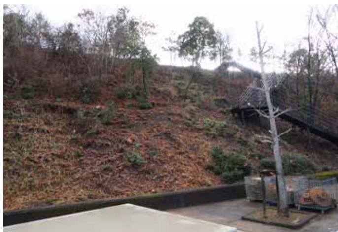
敷地東斜面（一部）は除草のみ。切土面から森林化進まず
