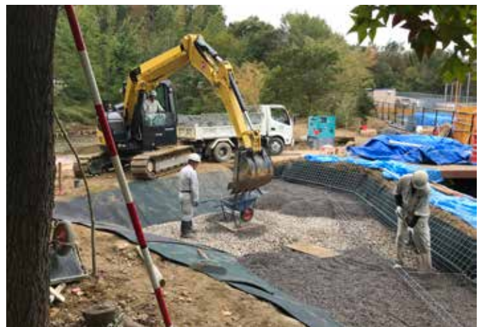
曝気および湧水からの生成物の沈殿を行う沈殿池
